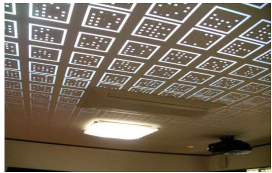
天井設置型モーションセンサー
